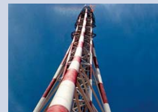
150 m Flare tower in Rayong Thailand Verfahrenstechnik: Prematechnik GmbH, Frankfurt
